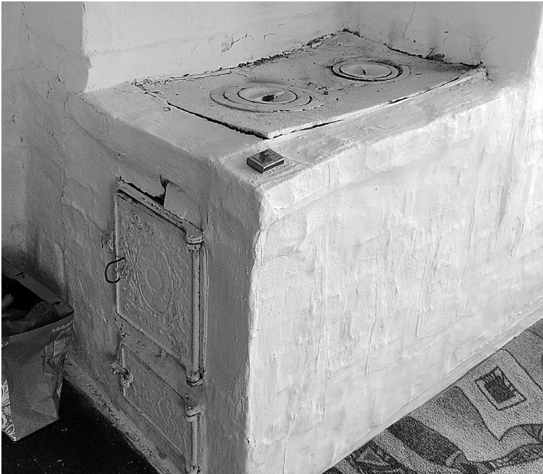
Замажьте трещины на печи, побелите ее и затапите - из щелей не должен валить дым
