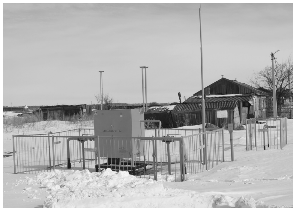
Газорегуляторный пункт на въезде в село
